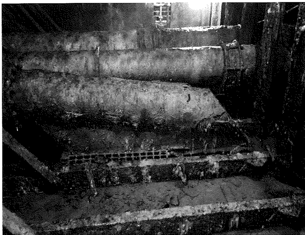
PIGNA DI ASPIRAZIONE IMPIANTO ESTRAZIONE
